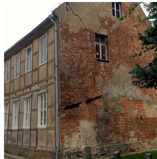
Westgiebel vor Sanierung, Foto: W. Eifrig
